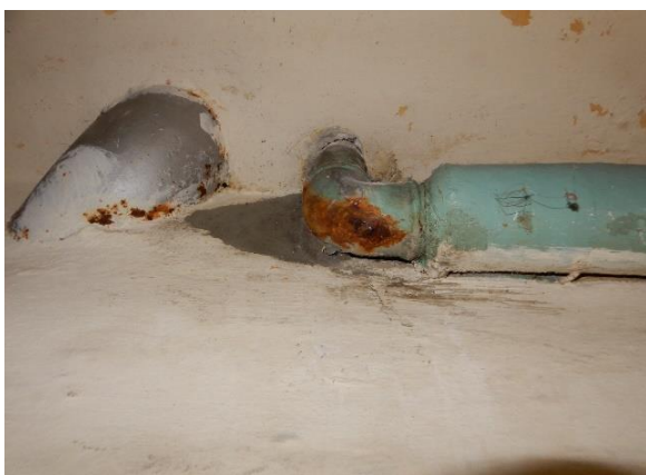
Tæring på rør i kælder
