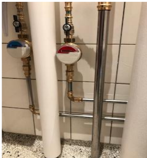
Eksempel på målerinstallation på WC
