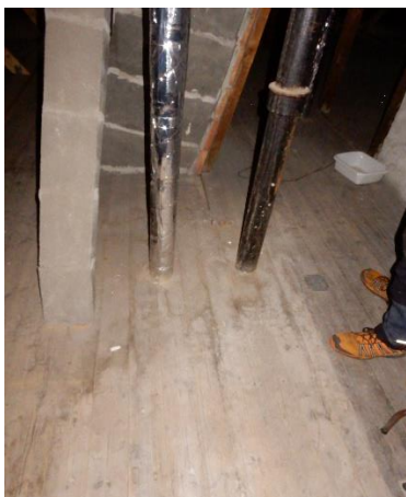
FS udluftning i loftrum
