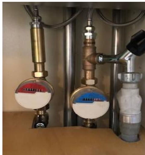
Eksempel på målerinstallation i køkken
